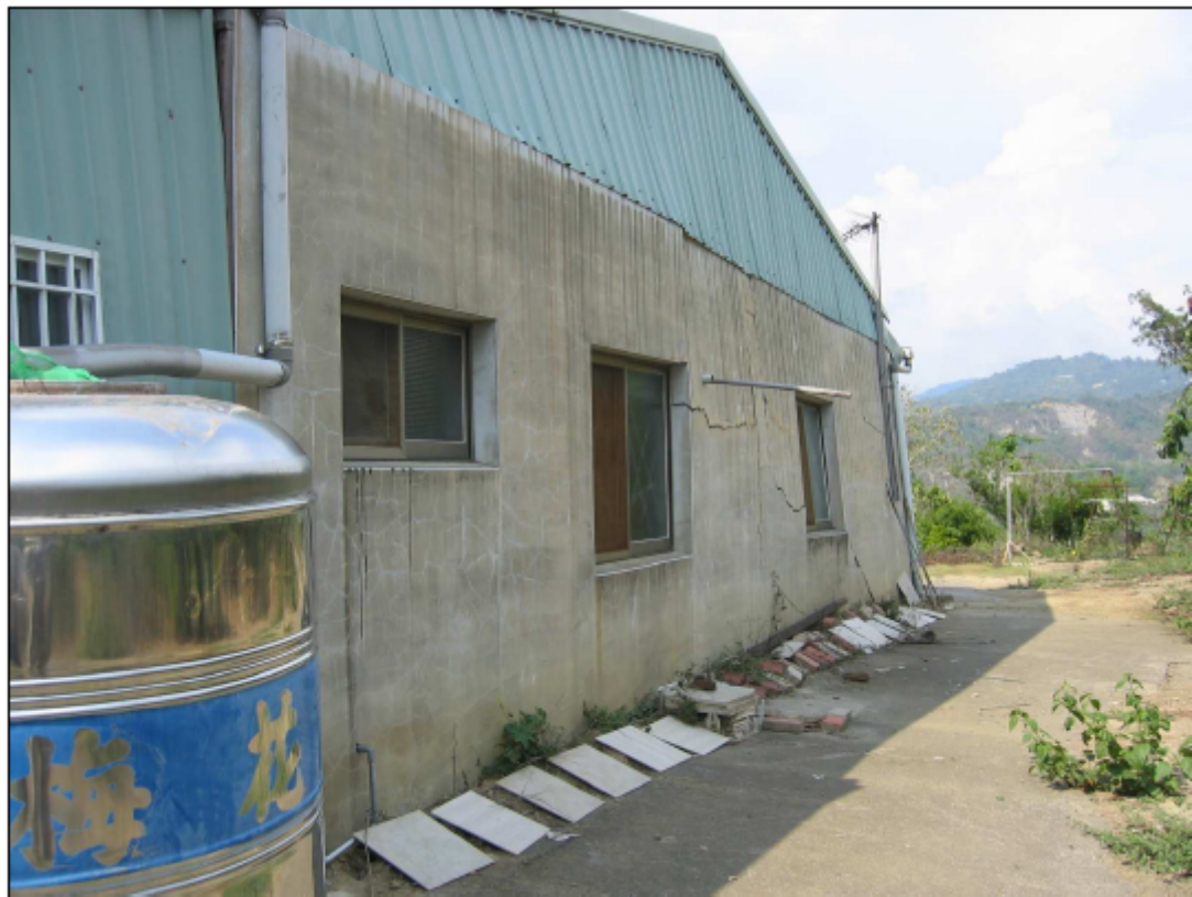
照片說明：房舍嚴重變形變形與龜裂，不堪居住。
