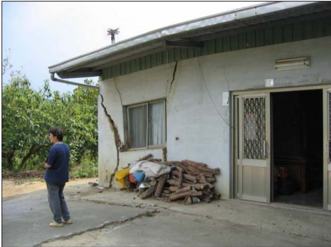
照片說明：西興村 6 鄰 1 號房舍及地坪嚴重龜裂，住屋不堪居住。
